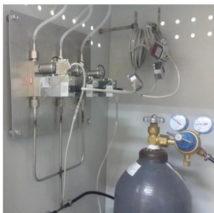
Рисунок 3.20 – Высокоточная система подачи водорода
